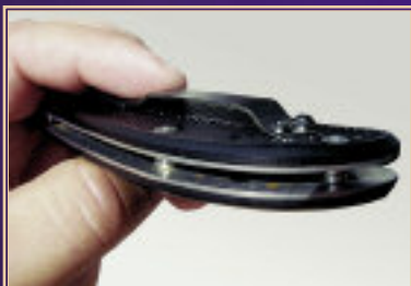
Следы коррозии на стальных лайнерах
